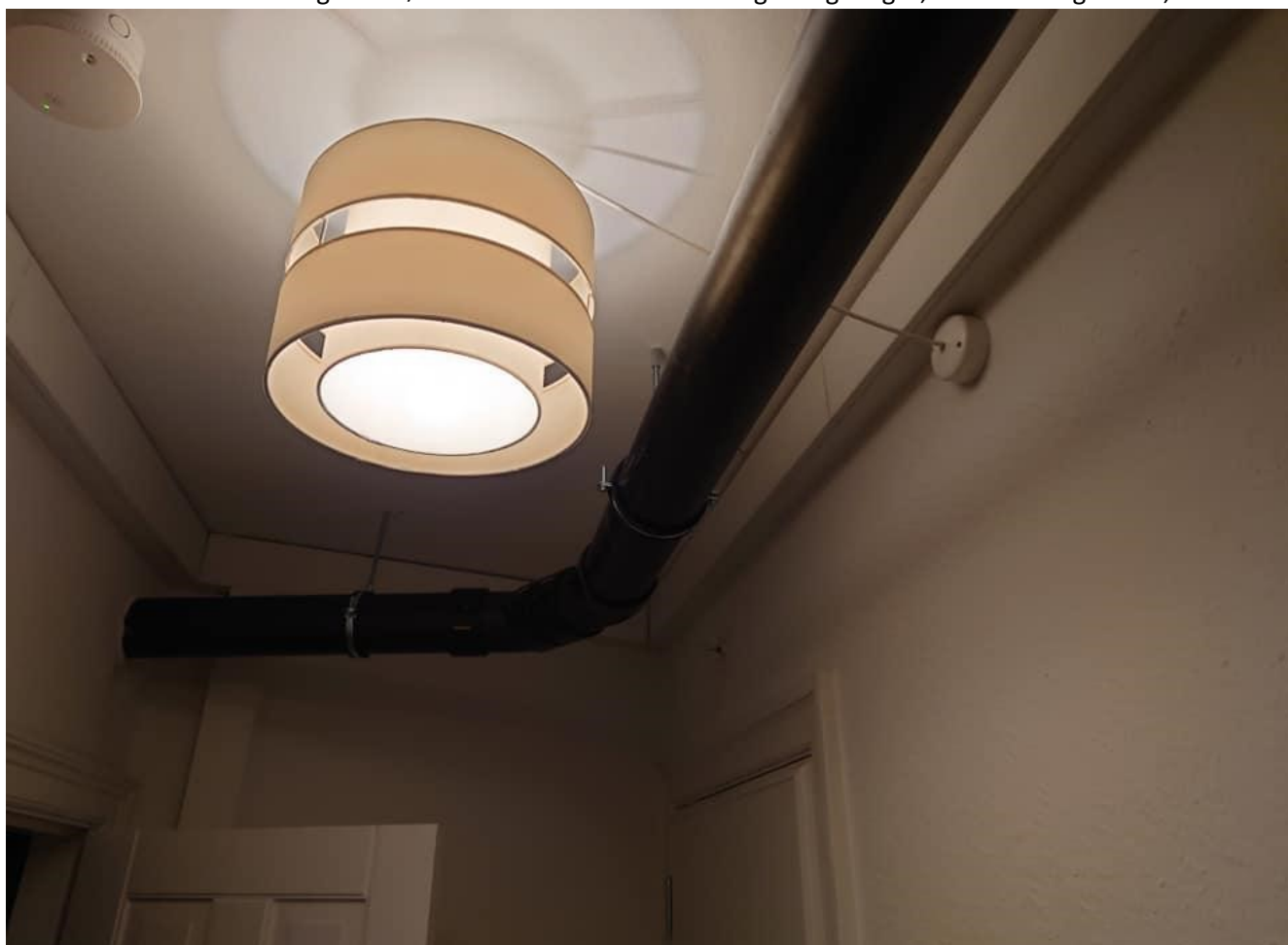
Værdiforringende rørinstallationer - ifm etablering af tagboliger; Markmandsgade 10, 5. TV
