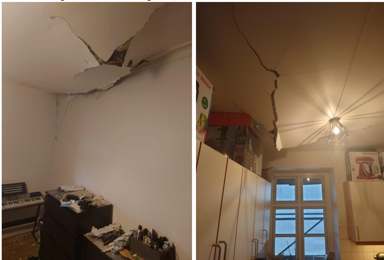
Loftgennembrud Markmandsgade 10, 5. TV
