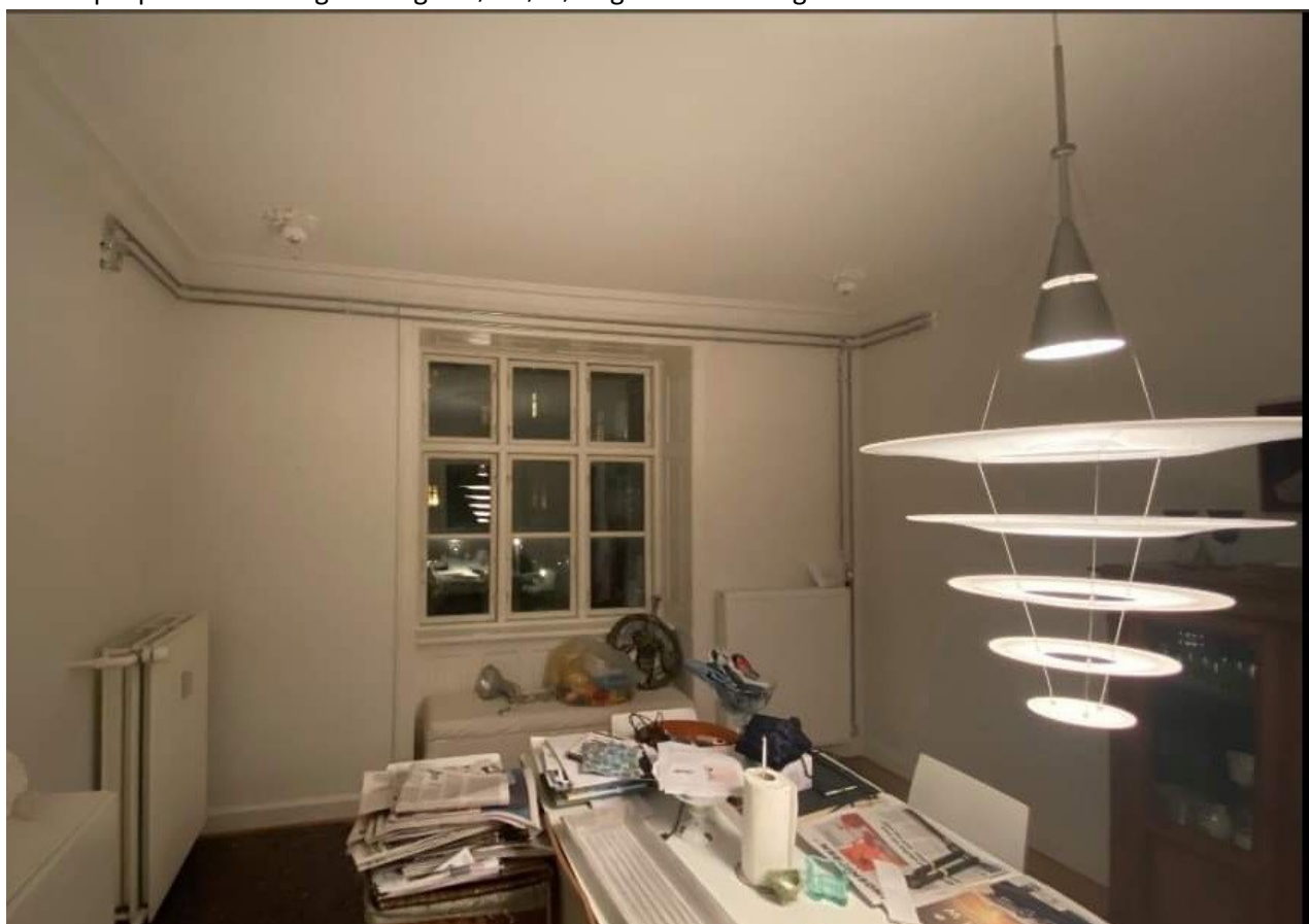
Eksempel på værdiforringende og uskøn rørføring i Markmandsgade:
