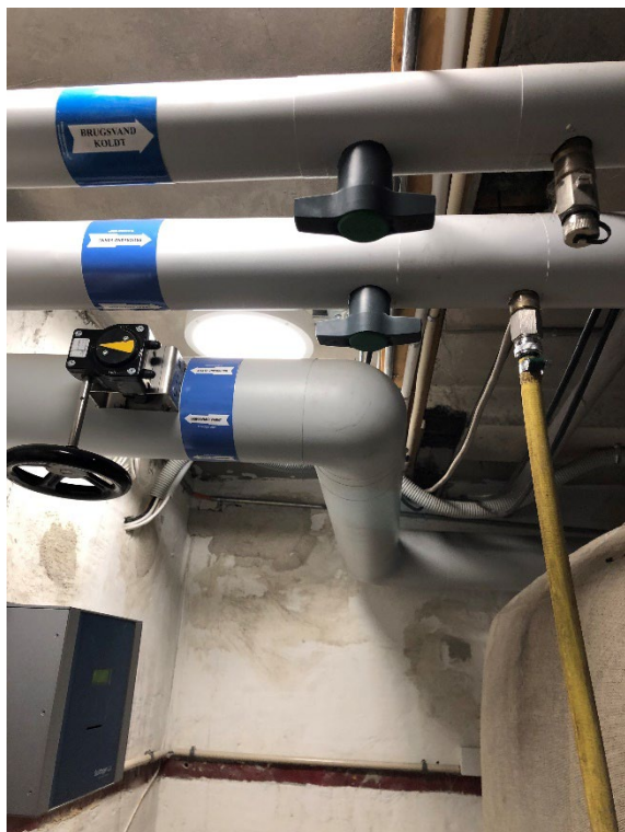
Foto 4. af koldt og varmtvandsinstallationer ved varmtvandsbeholder i varmecentral.
